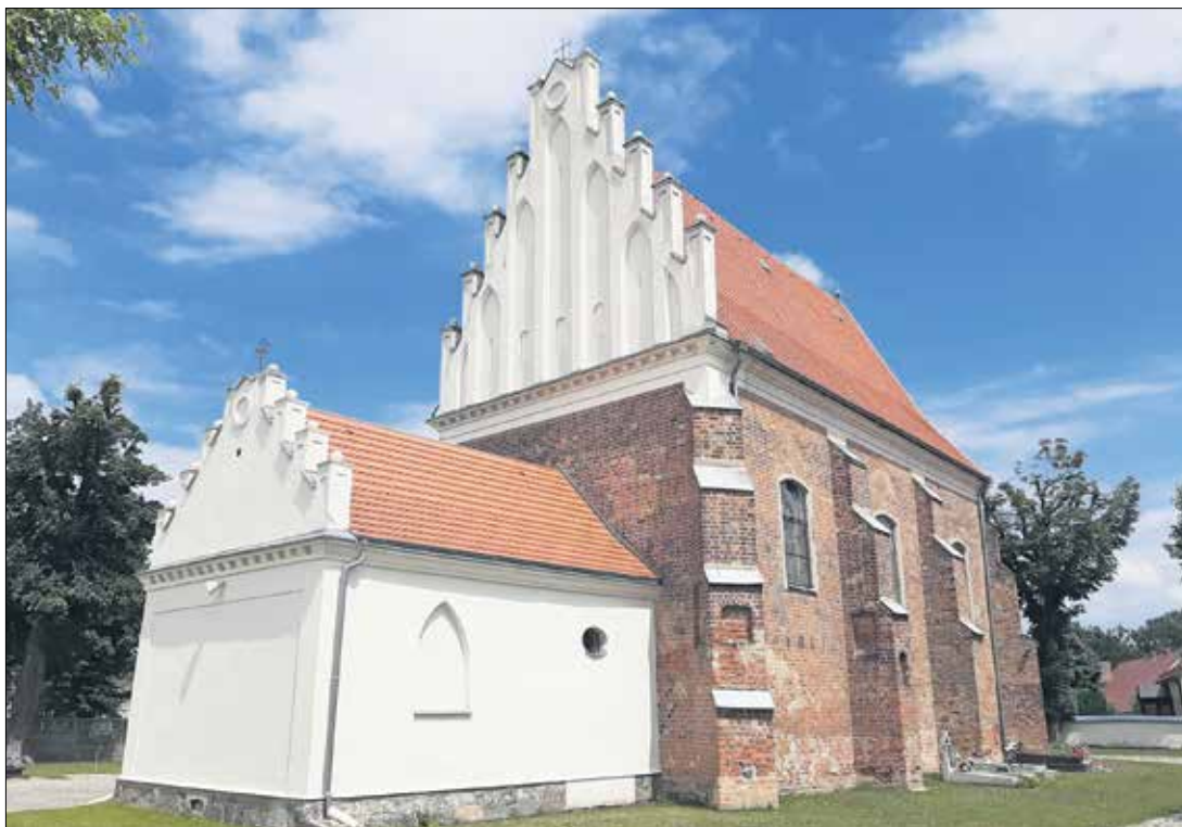
Kościół w Niepruszewie - elewacje ceglane przed remontem.
